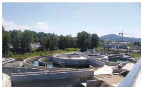
Station d'épuration Furania - Ville de St-Etienne
