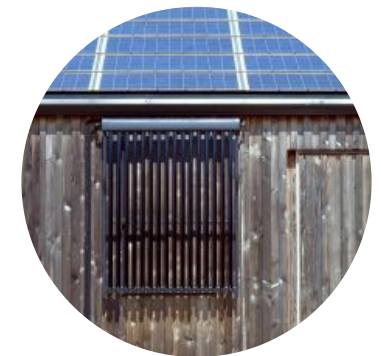
Toiture photovoltaïque complète - Anet (28) - Atelier Desmichelle
